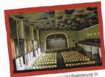
Der große Saal des Hauses der Begegnung in seinem Zustand vor der Sanierung.
